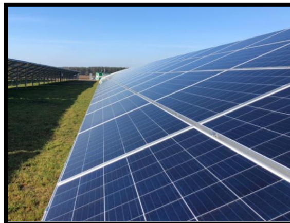
Zdjęcie 2 Polikrystaliczne panele fotowoltaiczne
