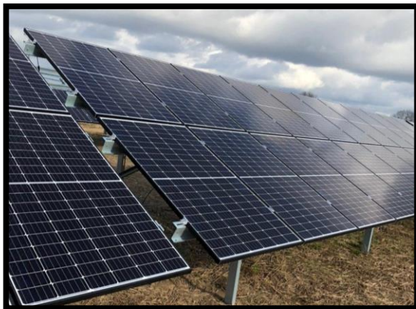
Zdjęcie 1 Monokrystaliczne panele fotowoltaiczne
