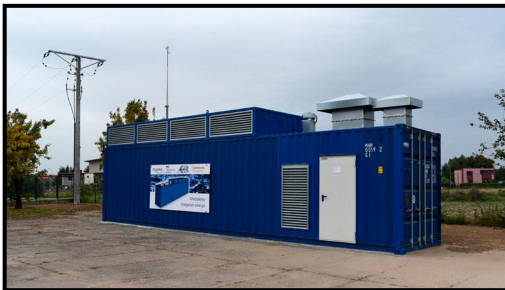
Zdjęcie 6 Przykład magazynu energii
